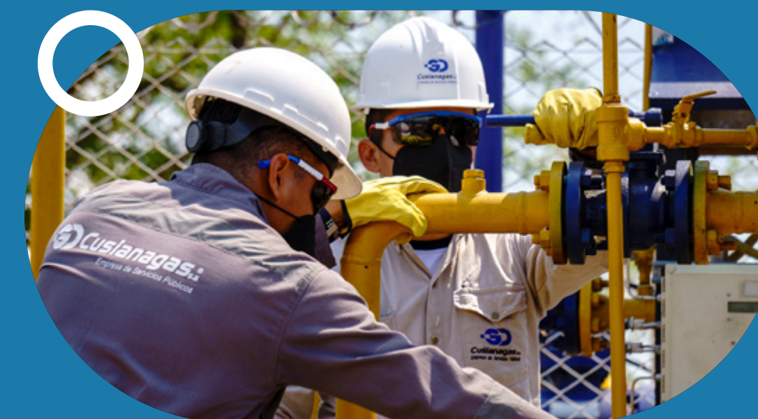
Suministro de gas (INDUSTRIAS Y EDS)
